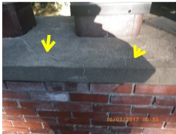
Ex: de la tête de la cheminée qui est à réparer
