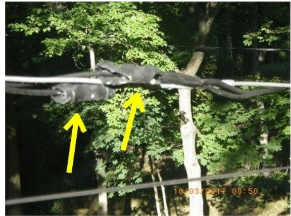
Ex: des isolateurs qui doivent être remplacés sur la ligne électrique
