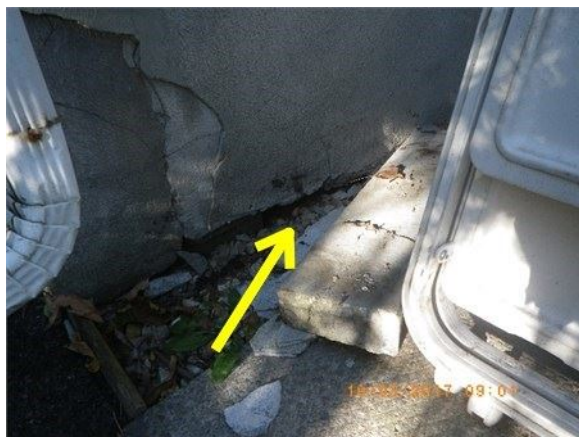
Ex: d'espaces libre sous la fondation de blocs de ciment où la vermine peut s'infiltrer dans la maison
