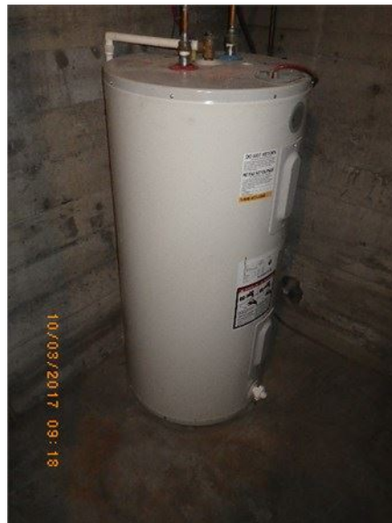
Ex: du réservoir d'eau chaude en place
