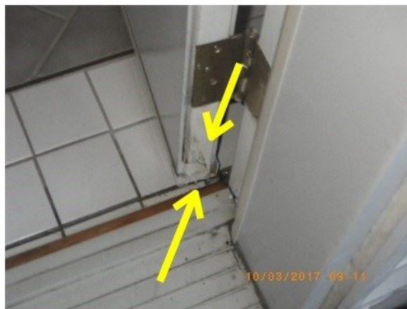
Ex: du cadrage de bois de la porte avant qui est pourri et où ils ont colmaté avec un scellant quelconque
