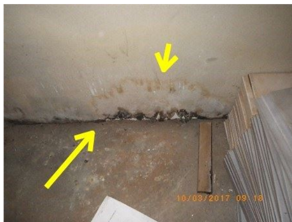
Ex: des traces d'eau visible au sous-sol dans la chambre à fournaise
