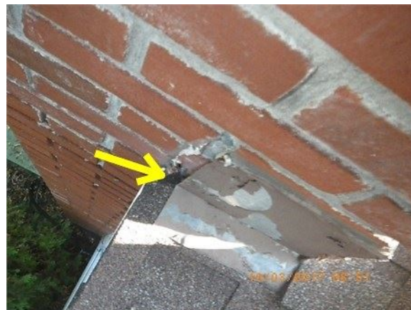
Ex: d'une autre partie du solin métallique à la base de la cheminée qui doit être scellé avec un scellant flexible pour l'étanchéité
