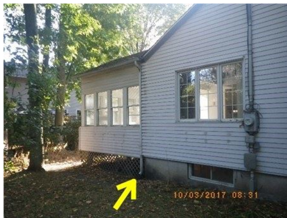
Ex: des descentes de gouttières qui se déversent contre la fondation de la maison
