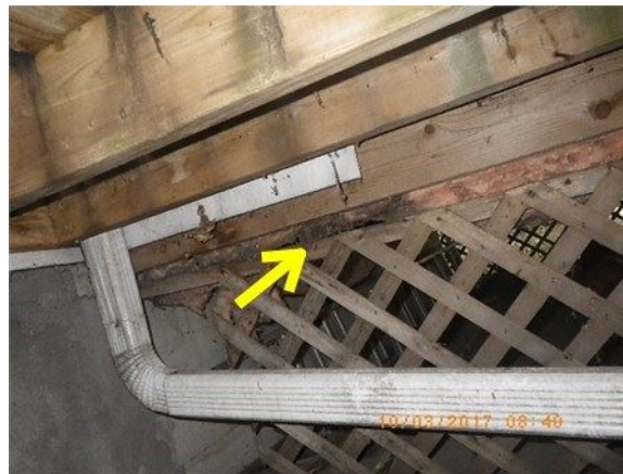
Ex: d'un autre emplacements où l'ont voit du bois de pourris sous la véranda
