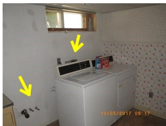
Ex: des conduites d'eau dans le mur extérieur de la salle de lavage
