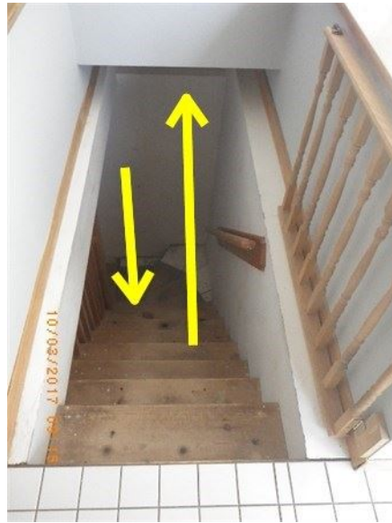
Ex: de l'échappée restreinte dans l'escalier du sous-sol
