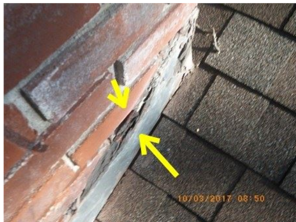
Ex: du solin métallique à la base de la cheminée qui doit être scellé avec un scellant flexible pour l'étanchéité
