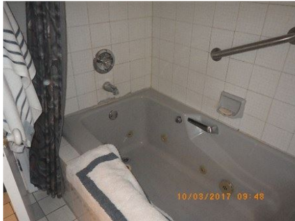
Ex: de la salle de bain qui est a refaire au complet
