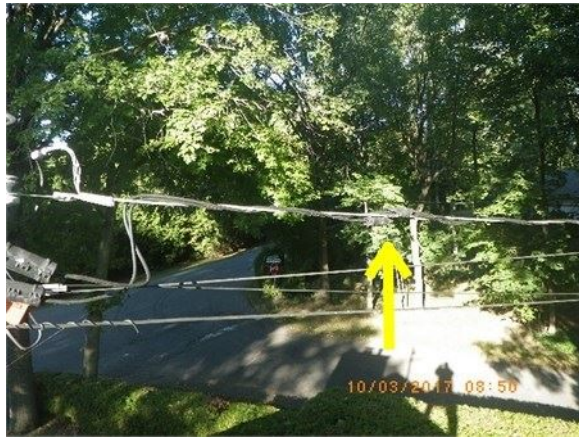
Ex: de l'emplacement de ces isolateurs a remplacés
