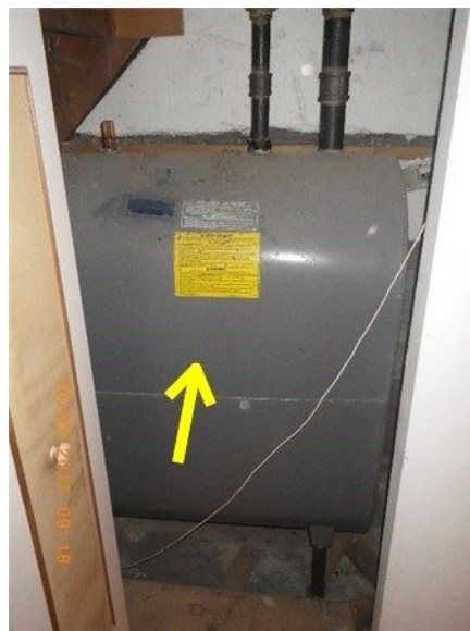
Ex: du réservoir de mazout en place au sous-sol
