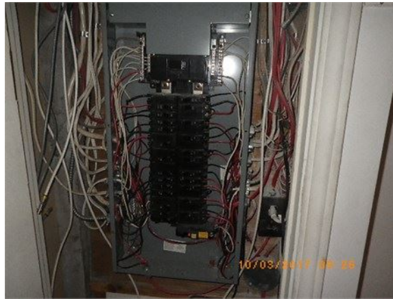
Ex: de l'intérieur du panneau électrique
