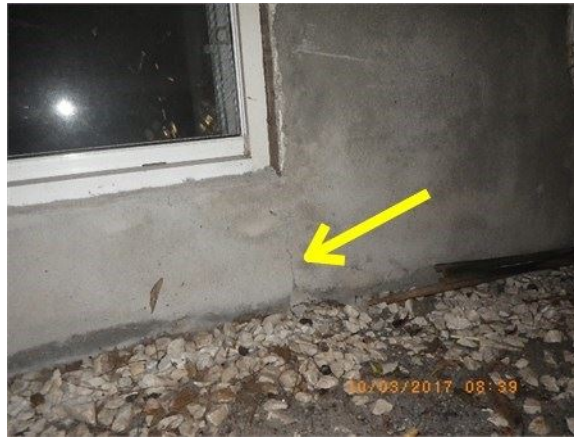
Ex: d'une fissure visible sur la fondation de béton coulé sous une fenêtre en arrière de la maison
