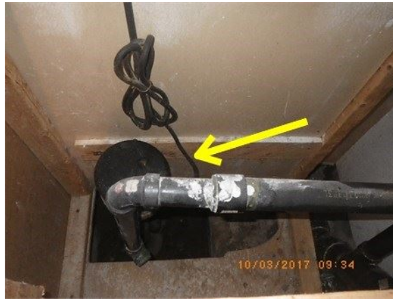
Ex: de la pompe submersible qui doit être remplacé par un plombier
