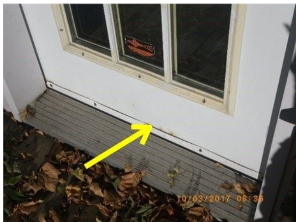
Ex: du métal rouillé de la porte arrière et son cadrage de bois qui est pourri à la base
