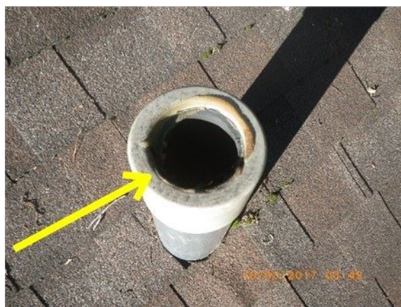
Ex: du contour de la finition de l'évent de plomberie qui doit soit être remplacé par un de la bonne dimension ou il doit être bien scellé avec un scellant flexible pour l'étanchéité.
