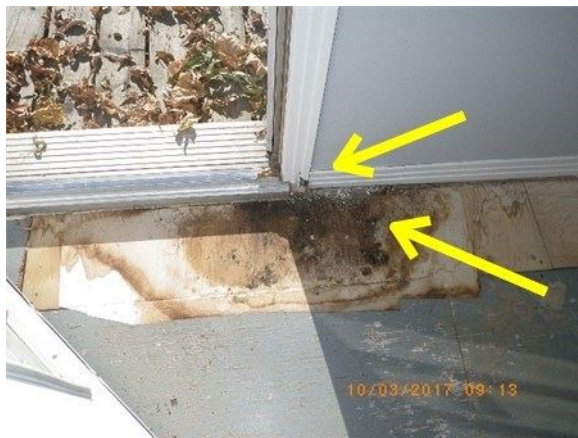
Ex: du bois de pourris visible dans la véranda
