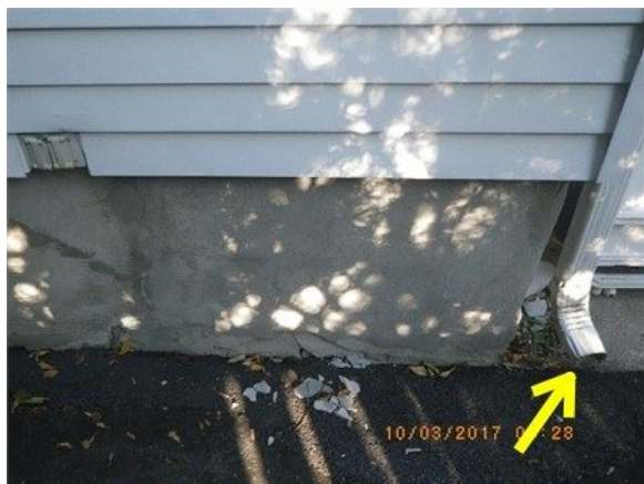
Ex: des descentes de gouttières qui se déversent contre la fondation de la maison
