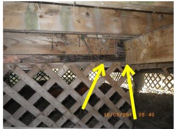
Ex: d'un des emplacements où l'ont voit du bois de pourris sous la véranda
