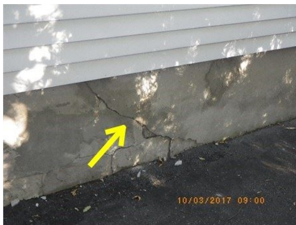
Ex: des fissures de déplacements de blocs de ciment
