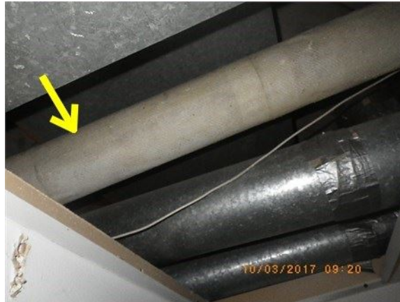
Ex: d'un conduit de ventilation qui est recouvert d'amiante
