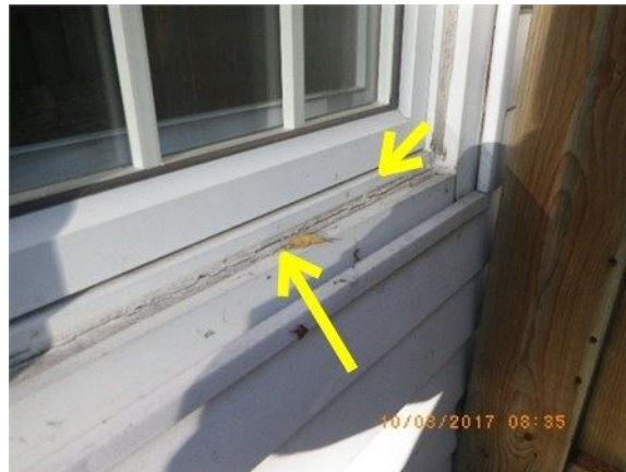
Ex: des joints de scellant qui sont à refaire à l'extérieur de cette maison pour l'étanchéité
