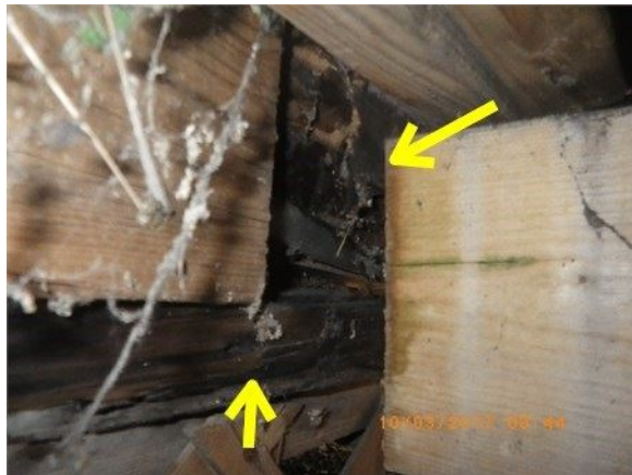
Ex: du bois pourris de la structure de la véranda qui est visible
