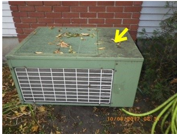
Ex: de l'unité de climatisation extérieur
