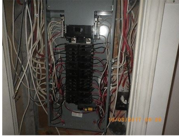
Ex: de l'intérieur du panneau électrique
