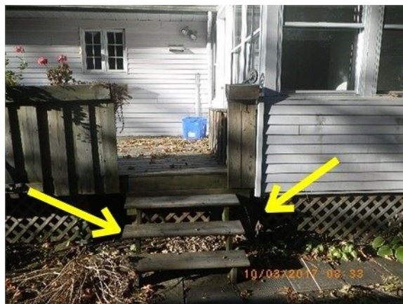
Ex: d'un escalier où ils manquent des rampes d'escalier
