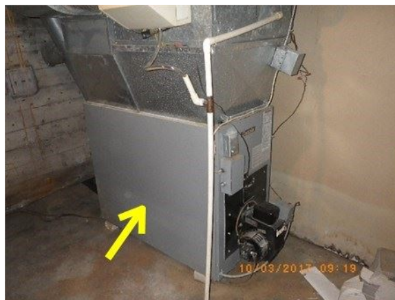
Ex: de la fournaise au mazout en place
