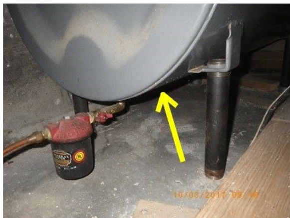
Ex: du réservoir de mazout en place au sous-sol
