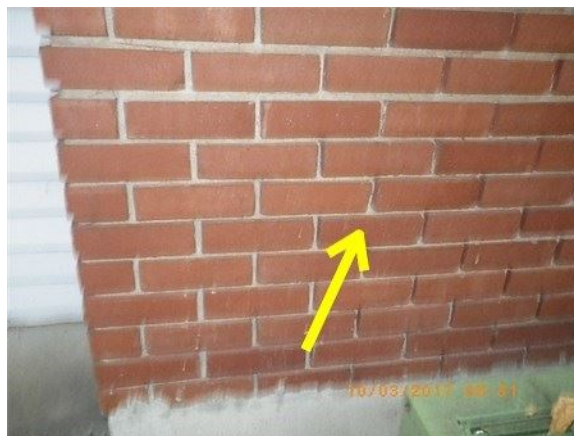
Ex: de joints de mortier qui sont à refaire sur cette cheminée de briques
