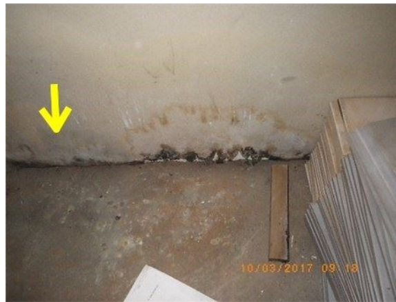
Ex: de traces de moisissures de visible au sous-sol lors de l'inspection
