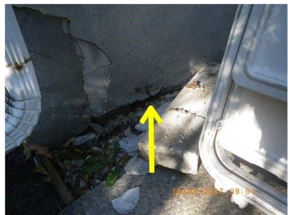
Ex: d'un des vides visible sous la partie de la fondation de blocs de ciment arrière
