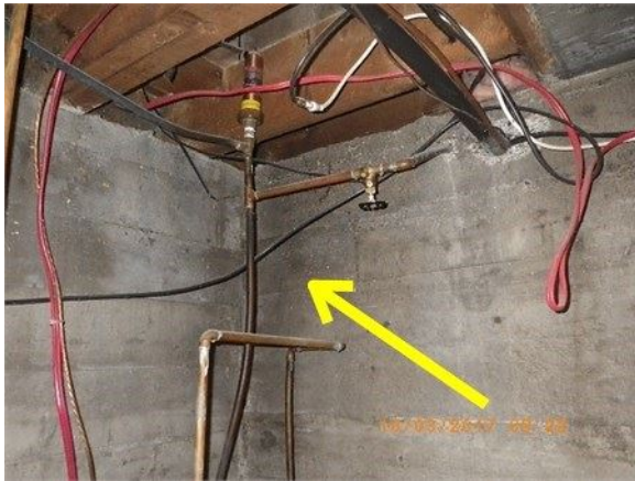
Ex: de traces de moisissures de visible au sous-sol lors de l'inspection
