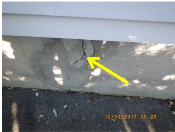
Ex: d'une autre fissure de visible entre les blocs de ciment
