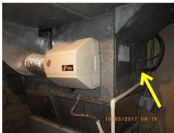
Ex: de l'emplacement du serpentins de l'air climatisé à l'intérieur de la fournaise
