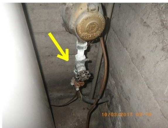
Ex: de la valve de l'entrée d'eau principale qui est a remplacée
