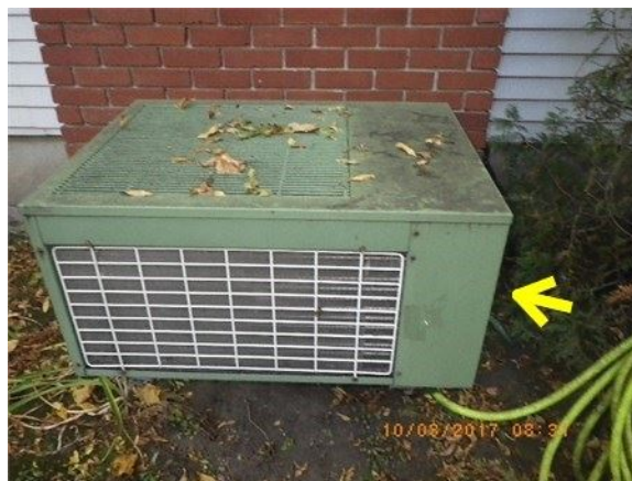
Ex: de l'unité de climatisation extérieur
